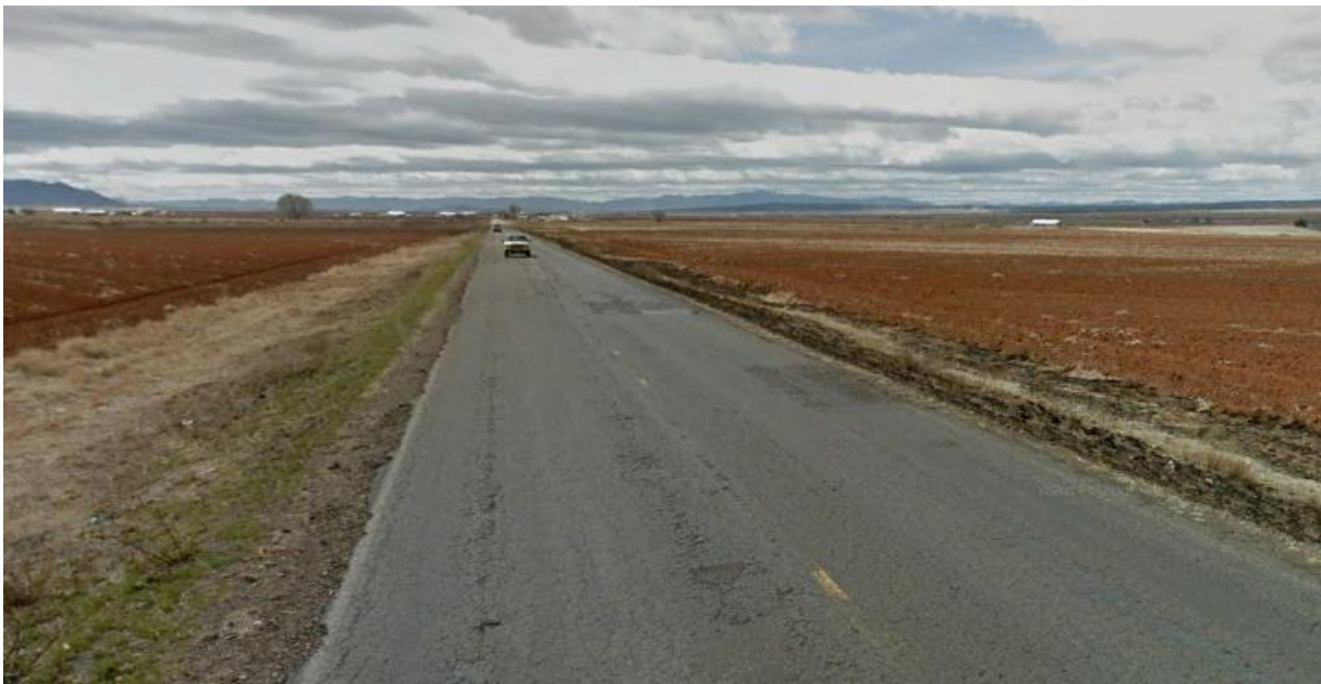
Figura No. 2. Vista del grado de deterioro que presenta el pavimento en Km 21+000
