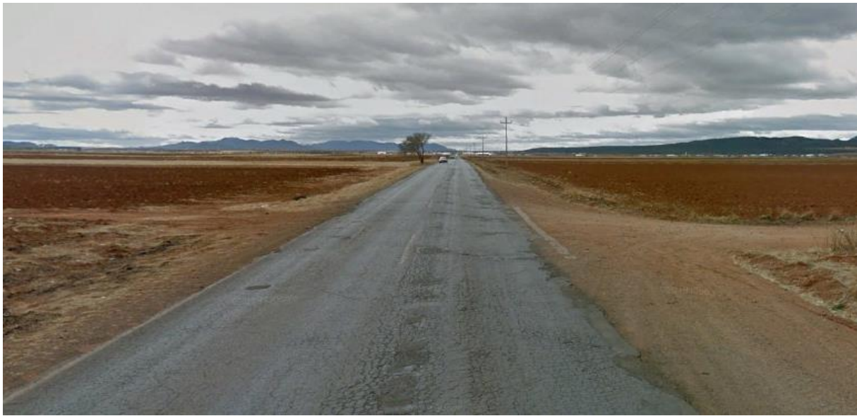
Figura No. 3. Vista del grado de deterioro que presenta el pavimento en Km 43+000
