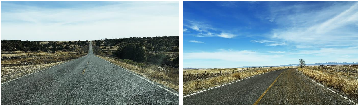
Fotografía 4. Tramos Carreteros con IRI de 2 a 4 m/Km
