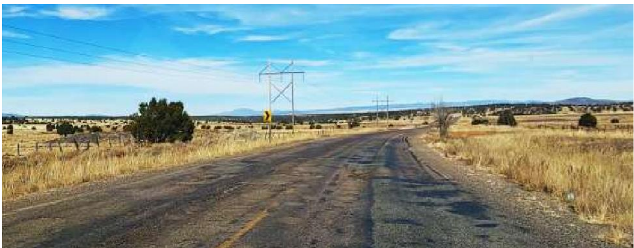
Fotografía 2. Tramo en Malas Condiciones en la Situación Actual
