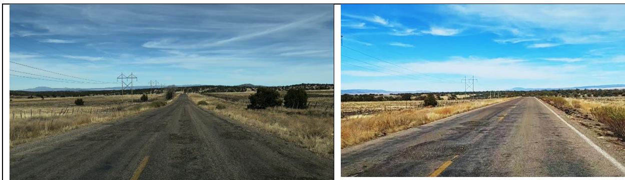
Fotografía 5. Tramos Carreteros con IRI de 5 a 7 m/Km
