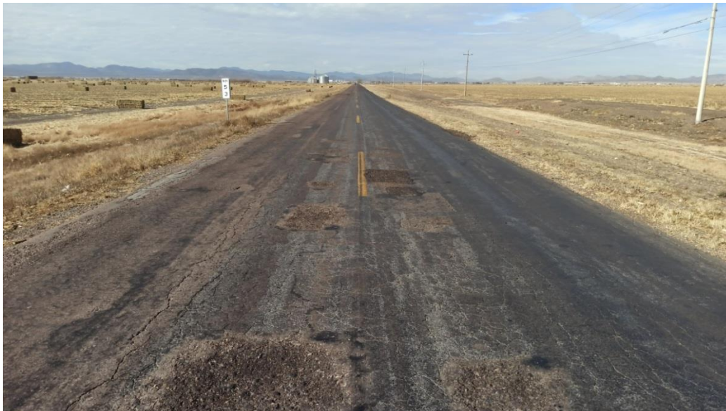
Figura No. 2. Vista del grado de deterioro que presenta el pavimento Km 53+000
