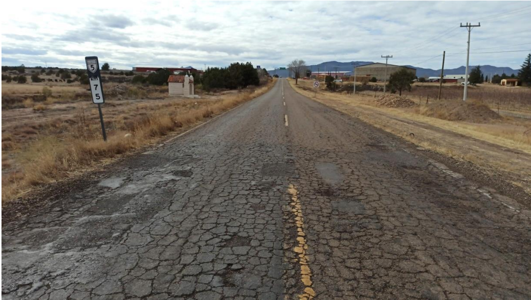
Figura No. 3. Vista del grado de deterioro que presenta el pavimento Km 75+000
