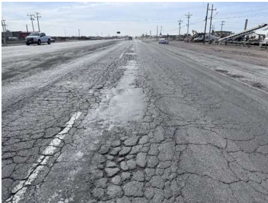
Imagen 16.- Condiciones actuales de pavimento.
