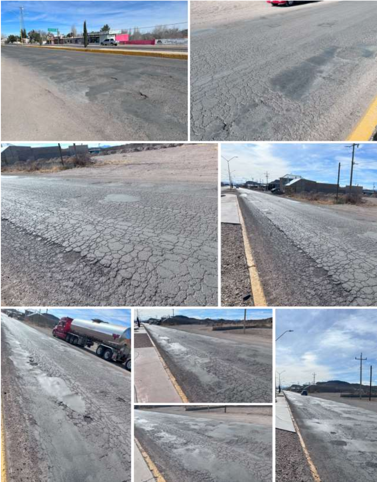
Imagen 11.- Estado actual de la carretera
