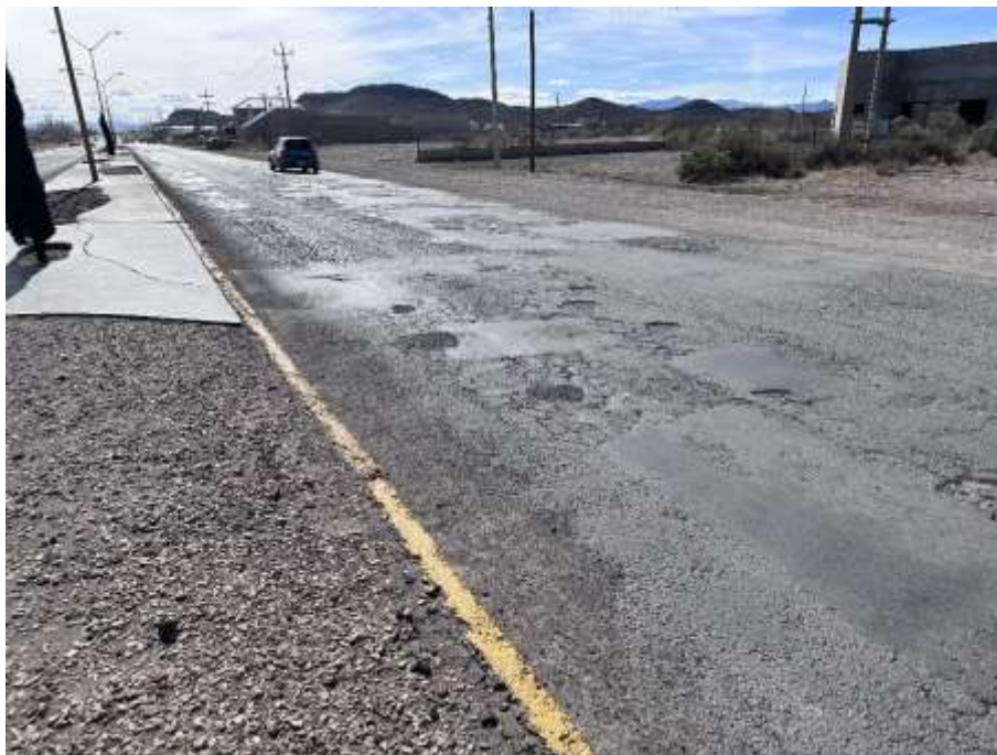
Imagen 17.- Condiciones actuales de pavimento.
