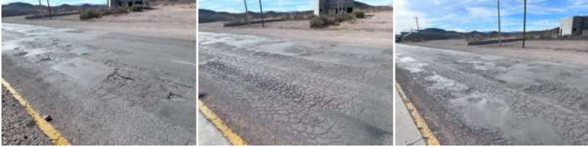
Imagen 30.- Zonas agrietadas en la Carretera (Piel de cocodrilo) a falta de riego de sello.
